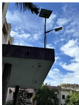
Fig: Solar street light
